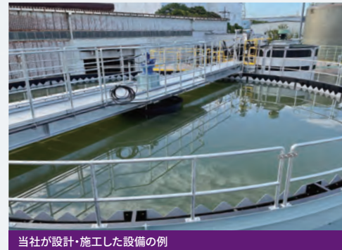
当社が設計・施工した設備の例
