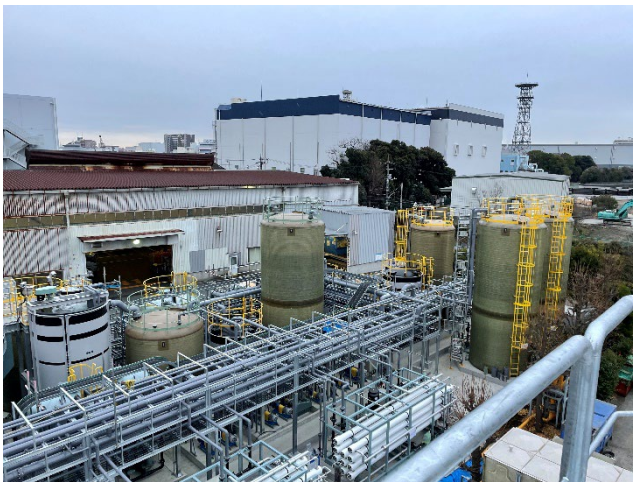
用地課題を解決するコンパクト化を実現した排水処理設備
